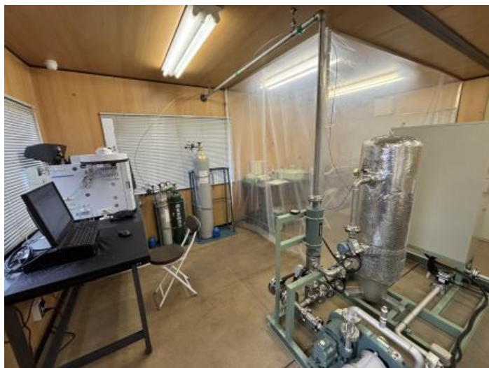
バイオマス発電所内実証拠点
